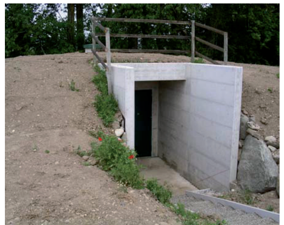
Le local sous-terrain abritant, en bas de la conduite, la turbine et le transformateur.
