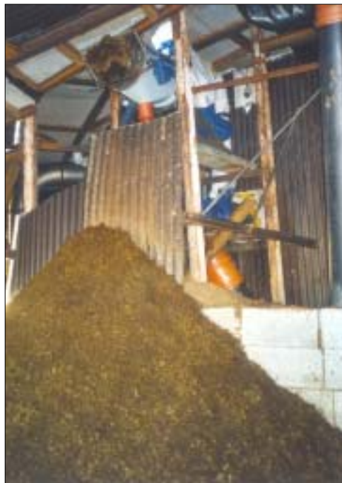
Installation de biogaz agricole, Puidoux (VD)
